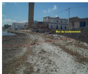
Photo 2 : Une mince couverture sédimentaire au pied d'un mur de soutènement au niveau du mosquée de Douira (Source : Maritec)
